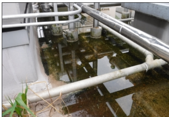
図 3-1 空調機械室[屋上](勾配不良による水溜り)
