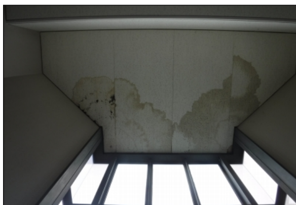
図 3-3 階段 D 踊り場[天井](漏水・カビ)
