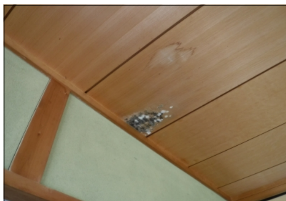
図 3-6 管理棟[和室天井](漏水・カビ)
