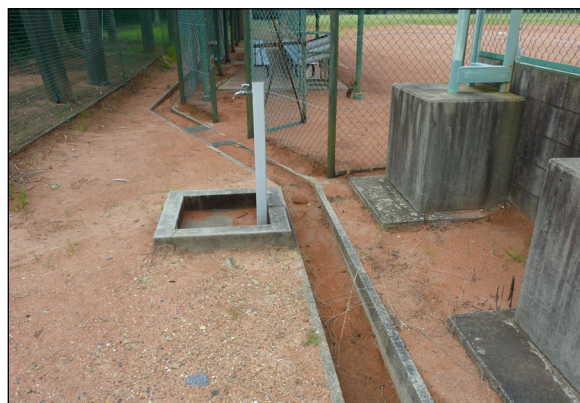
図 3-8 排水路(詰まり)
