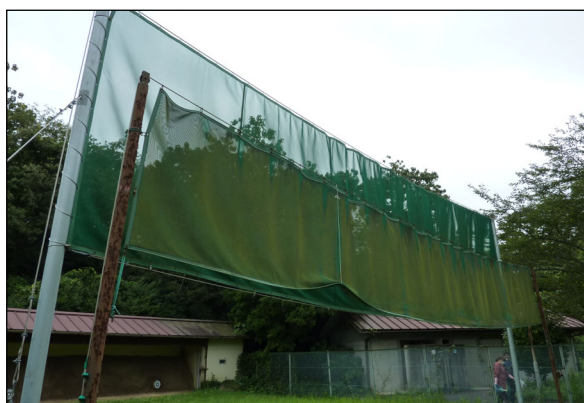
図 3-11 矢道[防矢ネット](錆)
