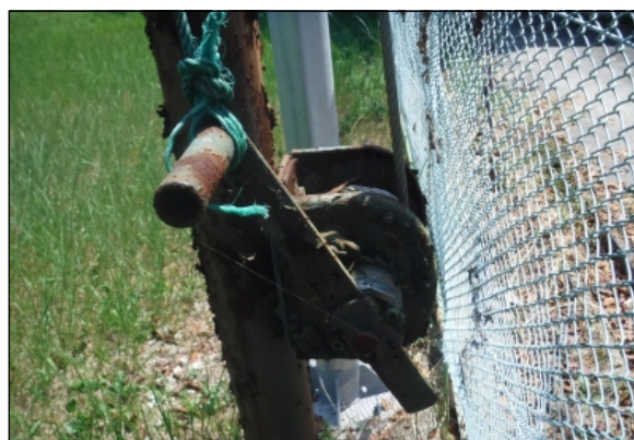
図 3-12 矢道[防矢ネットハンドル](腐食・操作不能)
