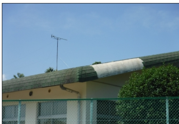
図 3-5 管理棟[屋根](屋根材剥離)
