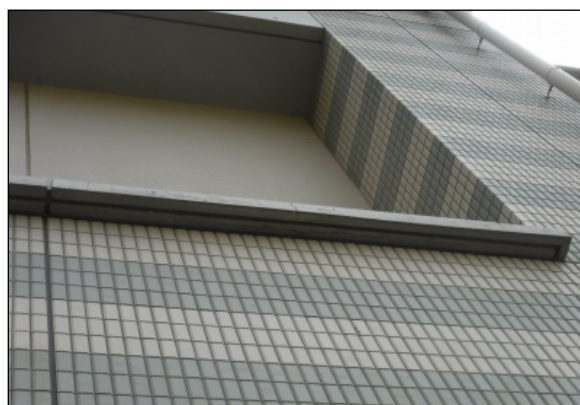
図 3-4 西面外壁[軒](ひび割れ)
