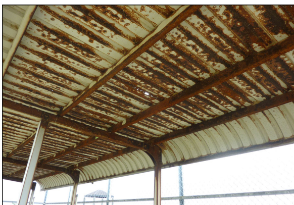
図 3-15 B面グラウンド・ベンチ[屋根](錆・穴)
