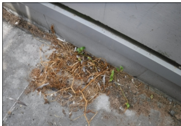
図 3-2 シンボルタワー北[屋上](ドレイン堆積、鳥糞)
